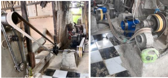
Gambar 2. Kondisi Mesin yang Menggunakan Mesin Diesel ke Motor Listrik
